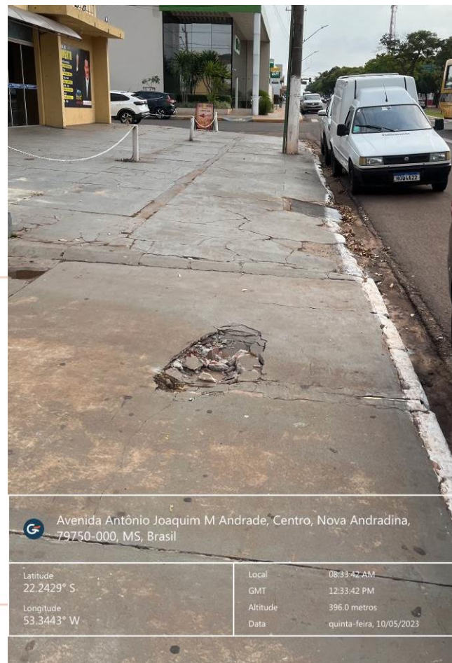
Figura 49 – Calçada sem acessibilidade com fissuras – Av. Antônio Joaquim M. Andrade
