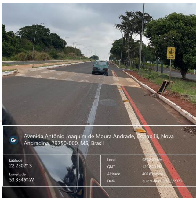
Figura 35 – Calçada não pavimentada – Av. Antônio Joaquim de Moura Andrade
