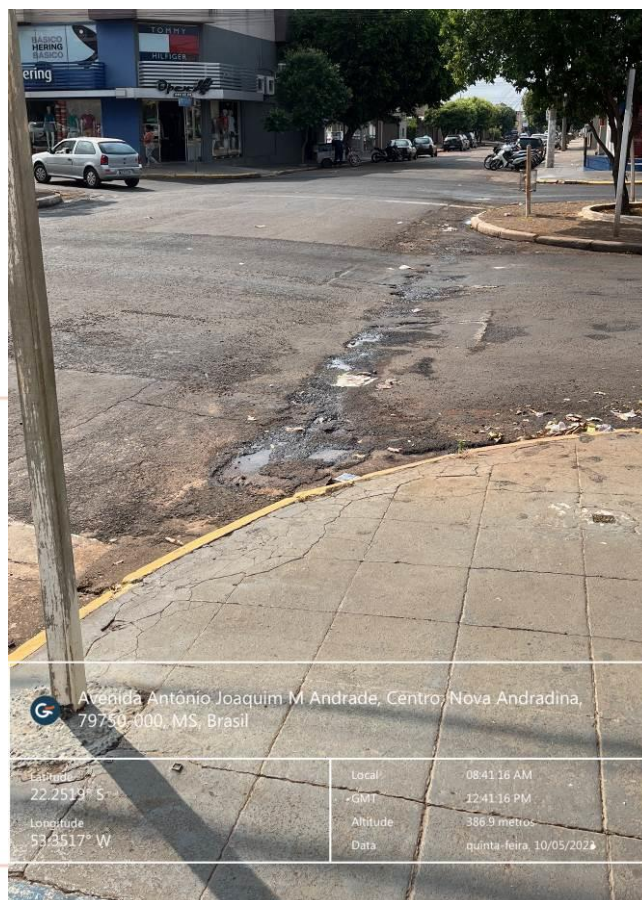
Figura 74 – Pavimento em péssimo estado – Av. Antônio Joaquim Moura Andrade
