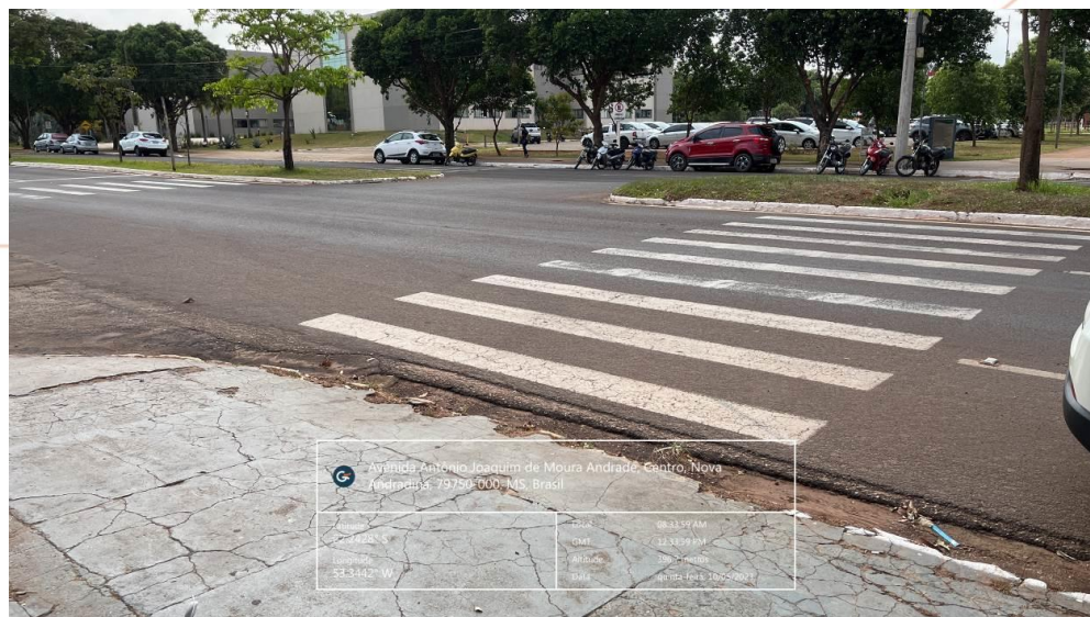
Figura 29 – Detalhamento travessia sem rampa de acessibilidade e com obstrução – R. Antônio Joaquim de Moura Andrade
