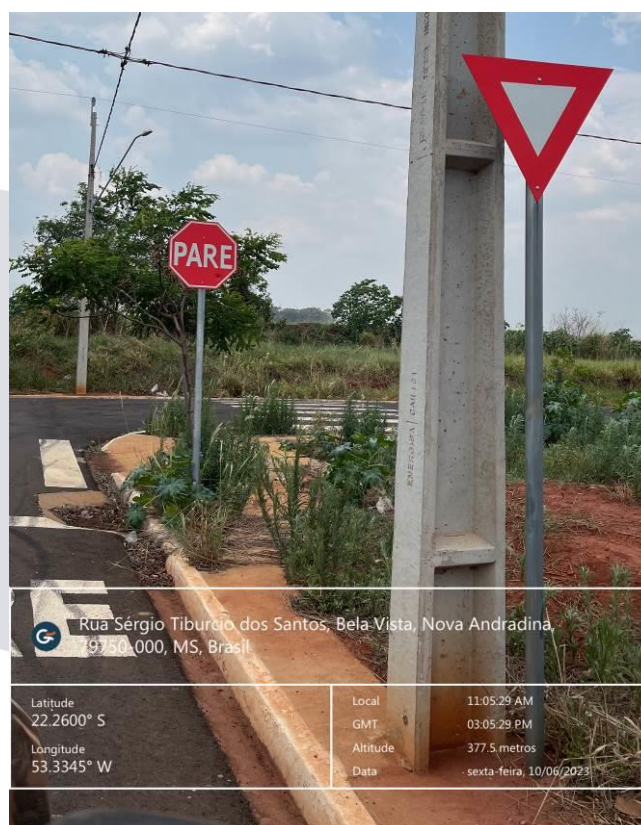
Figura 62 – Sinalização vertical em boa conservação– R. Walter Hubacher
