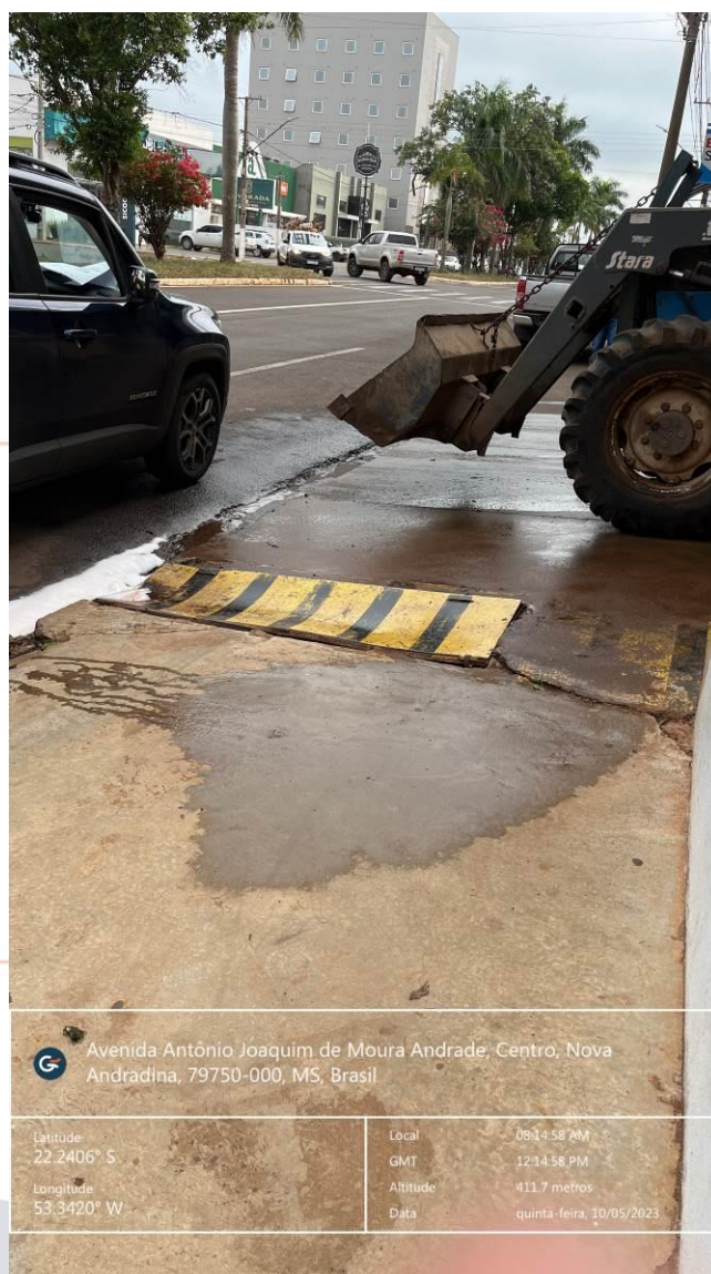
Figura 2 – Calçada obstruída – Av. Antônio Joaquim de Moura Andrade
