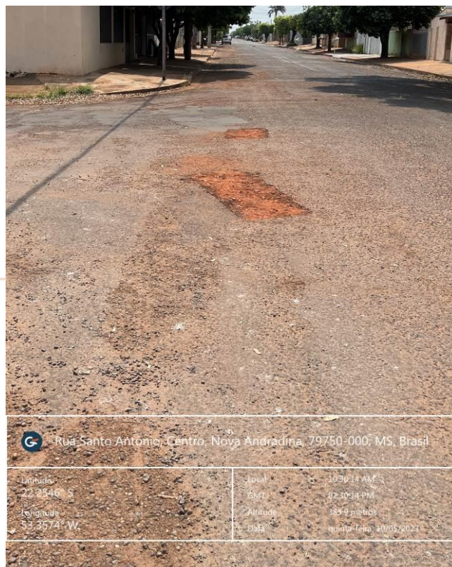
Figura 72 – Pavimentação em péssimo estado – R. Santo Antônio
