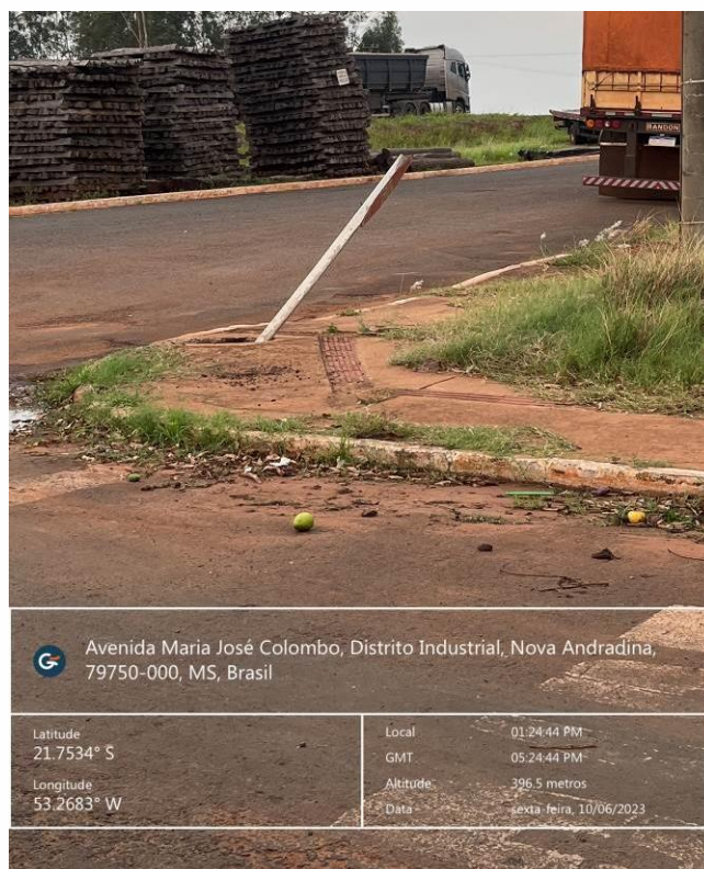
Figura 40 – Calçada com Piso Tátil Danificado– R. Maria José Colombo
