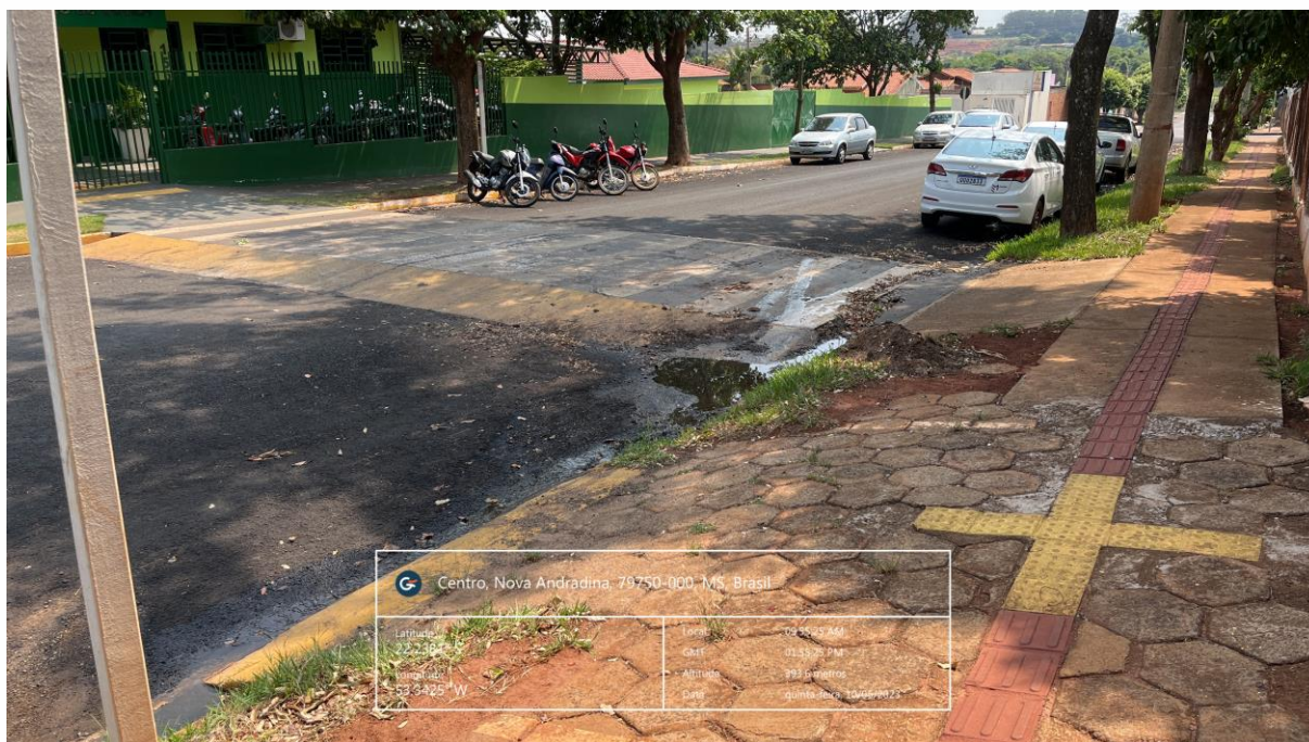
Figura 52 – Travessia Elevada Obstruída em Área Escolar – Rua 7 de Setembro
