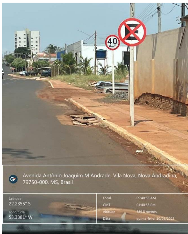
Figura 37 – Calçada com Piso Tátil Obstruído – Rua Oclécio José de Faria
