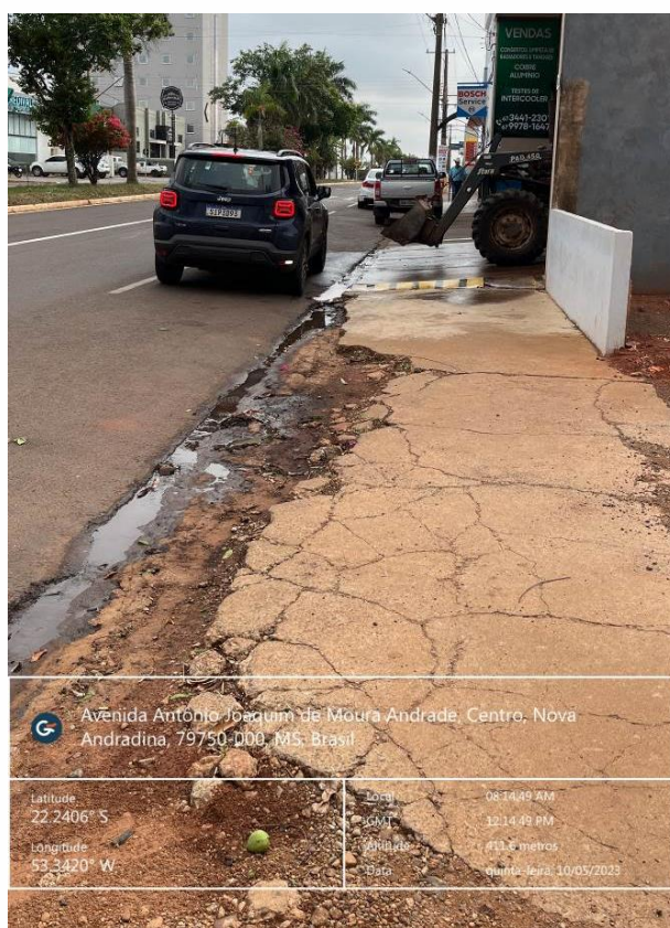
Figura 10 – Calçada sem manutenção – Av. Antônio Joaquim de Moura Andrade
